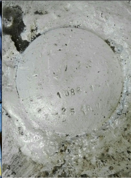
Foto N° 4. Placa de identificación del pozo pz-09-0031, en mal estado
