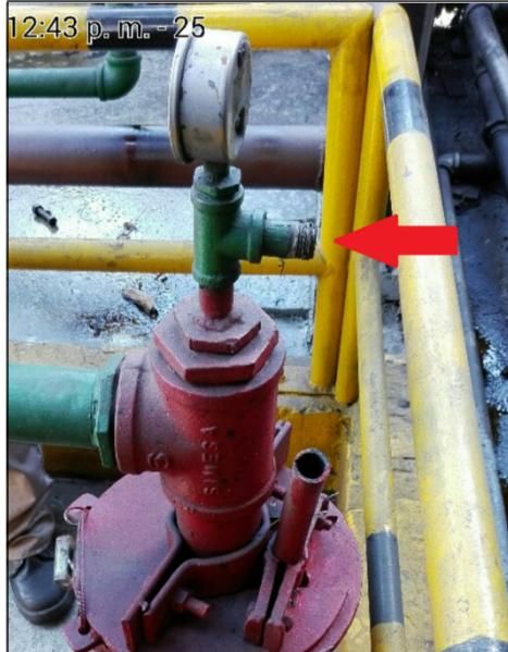
Foto N° 3. Tubería de inyección de aire deshabilitada
