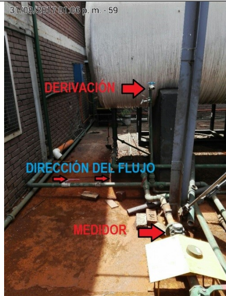
Foto N° 5. Tubería cabeza de pozo - Almacenamiento. Derivaciones.
